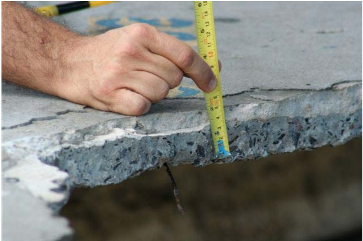
Foto 07. – Vista da espessura da laje rompida.
