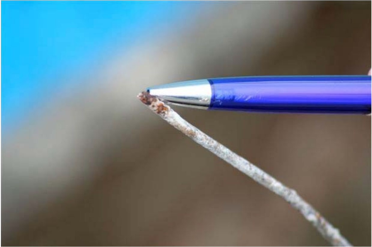
Foto 09 – Detalhe do ponto de ruptura da armadura da laje.
