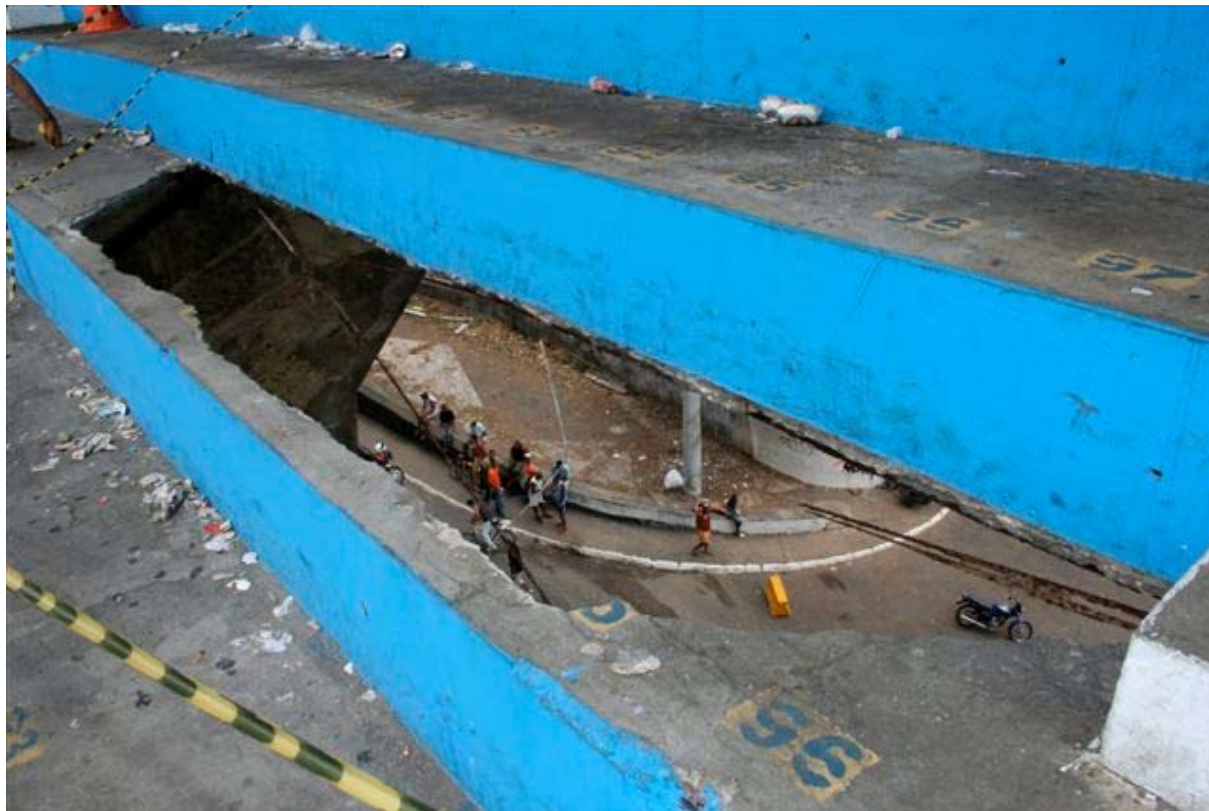
Foto 06 – Vista da altura do sinistro para a parte externa.
