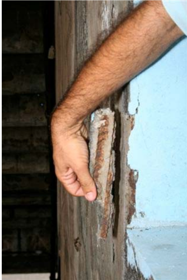
Foto 13 – Deslocamento do concreto no pilar.
