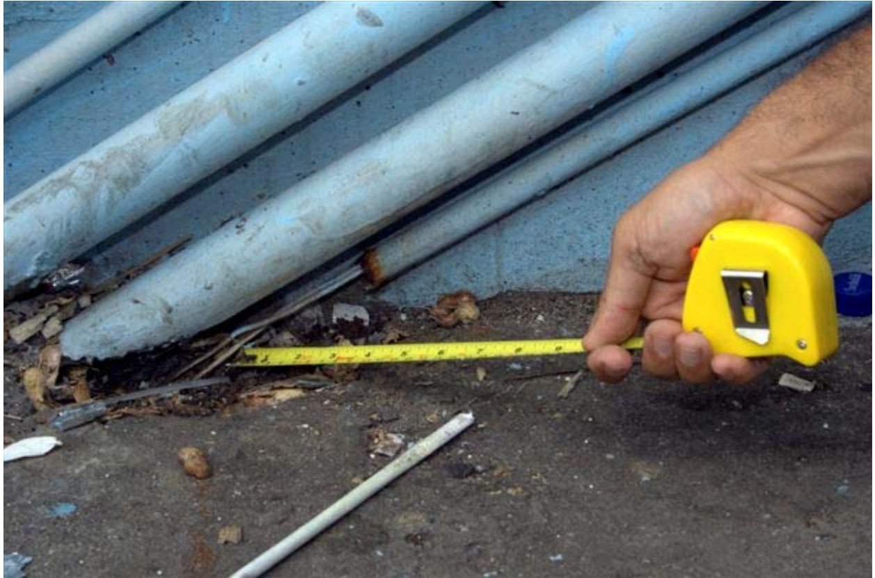
Foto 16 – Detalhe de fiação elétrica exposta de forma indevida.
