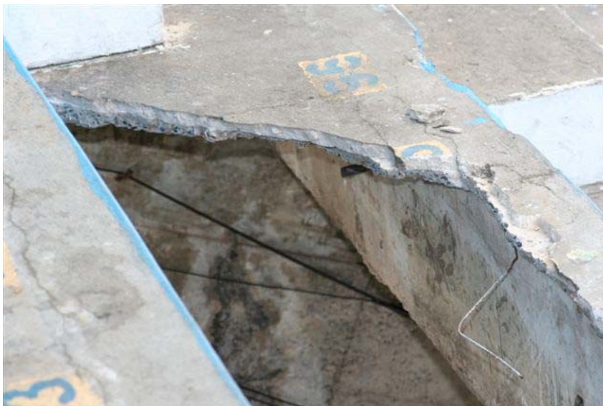
Foto 05 – Detalhe da ferragem da laje rompida.
