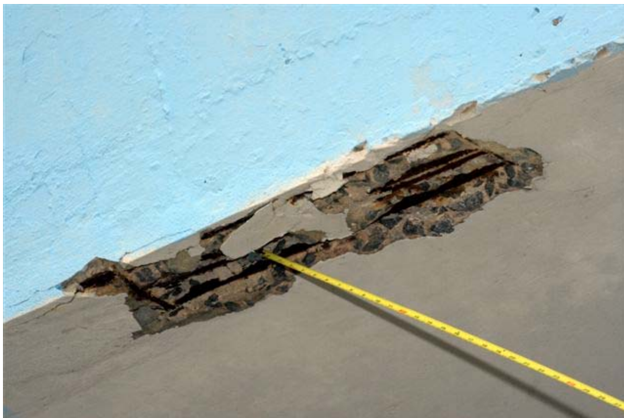
Foto 14 – Redução da seção da ferragem entre a laje e a viga de sustentação.
