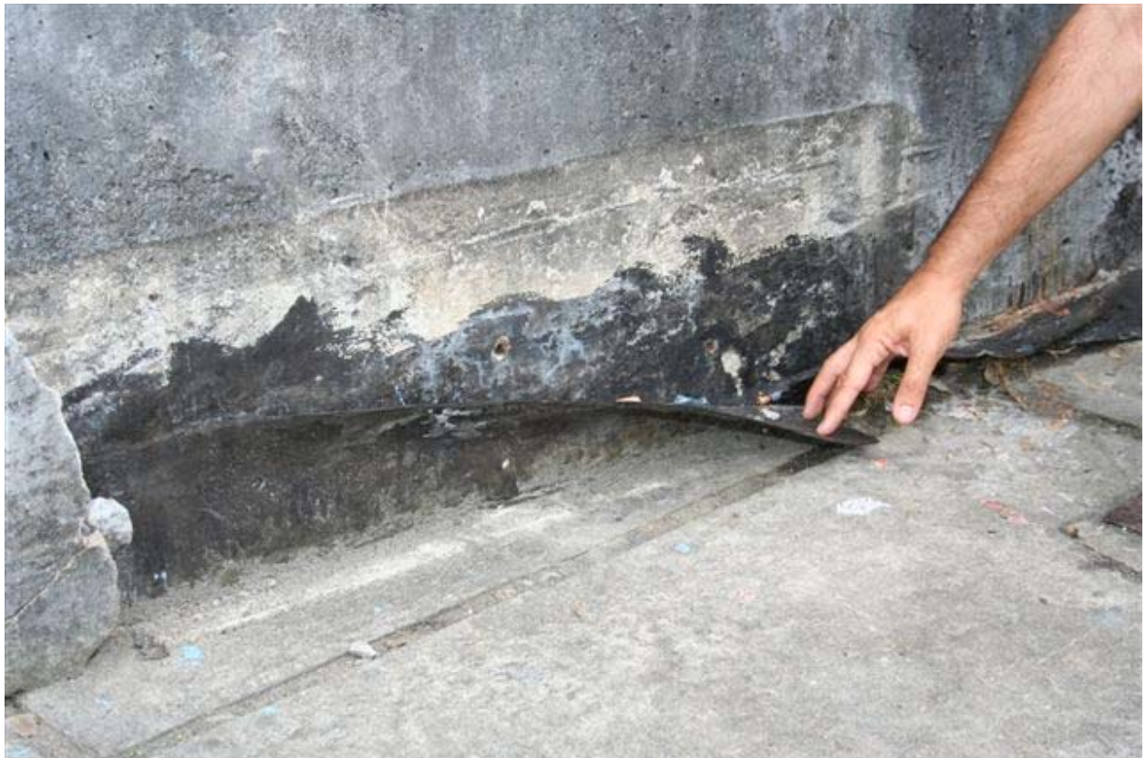
Foto 17 – Detalhe da manta de impermeabilização danificada.
