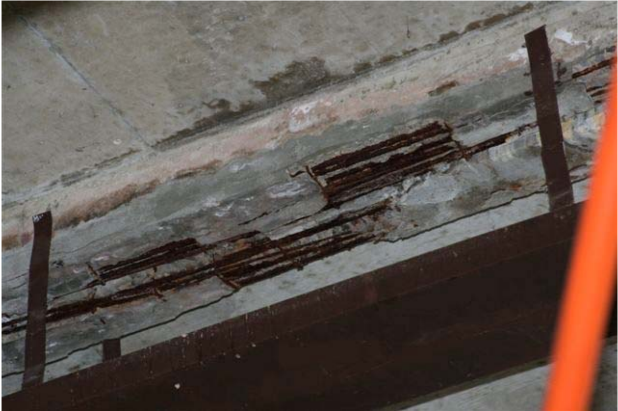
Foto 11 – Vista inferior de viga com deslocamento e corrosão da armadura.
