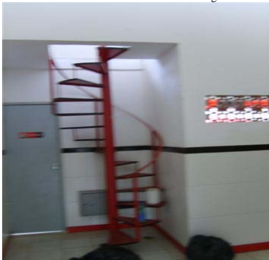
Foto n.º 17: Escada de acesso à varanda da imprensa sem guarda corpo na parte superior, não atendendo às normas de acessibilidade.
