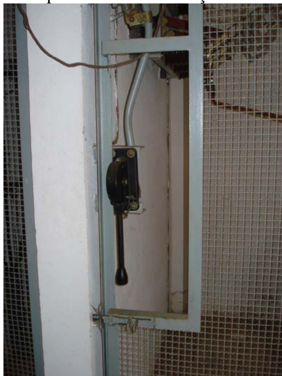
Fotos n.ºs 12 – Chave seccionadora
