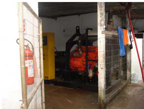
Foto nº 14 – Grupo Gerador de energia elétrica
