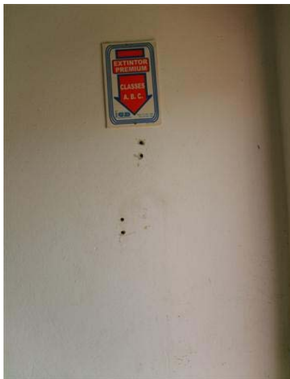
Foto n° 16 – Falta de extintor da casa de gerador.
