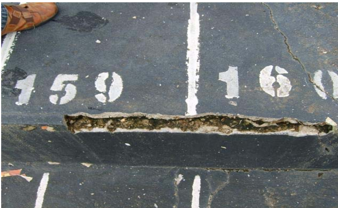
Foto n.º 06: Arquibancadas apresentando rachaduras, fissuras e com deslocamento do revestimento.
