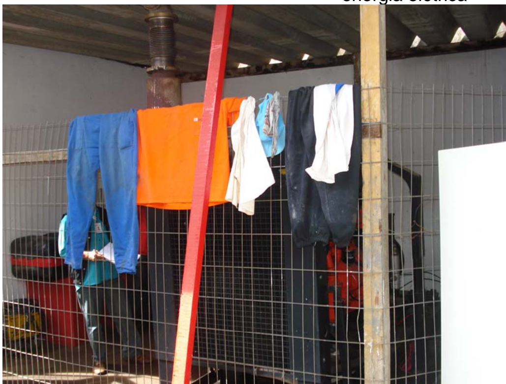
Foto n 15 - Grupo Gerador de energia elétrica
